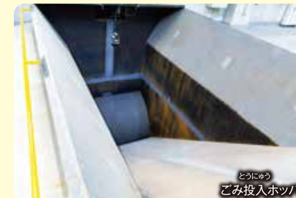
よくかきまぜられたごみは、ここから焼却炉に投入されます。
