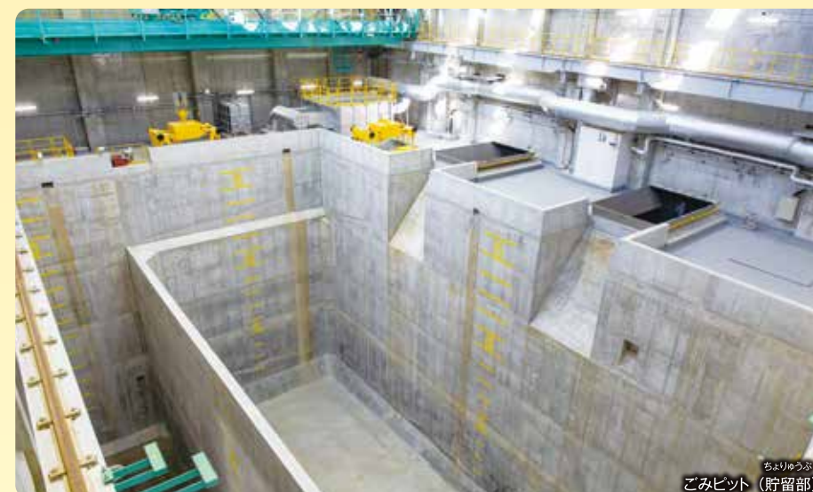
つぎにごみは受入部から貯留部に移動されます。 ごみには、燃えにくい水分の多い生ごみ、燃えやすい乾燥した紙くずやプラスチック製品などがあるので、よくかき混ぜます。
